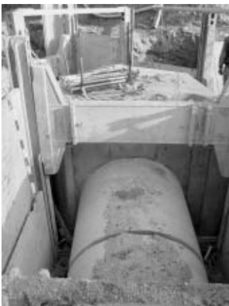
Schachtbauwerk mit Zuleitung Lohmühle DN 2000 (Durchmesser 2 Meter)
