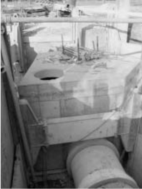
Schachtbauwerk mit Zuleitung Adalbert-Stifter Straße DN 1200 (Durchmesser 1,20 Meter)
